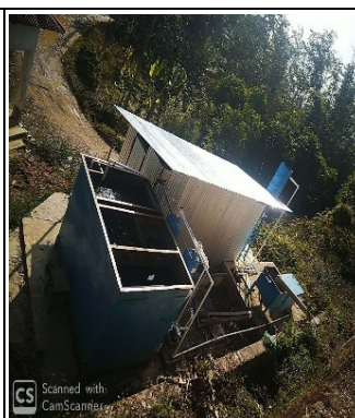
Photograph 5.11: Effluent plant without lids – DH Wokha
